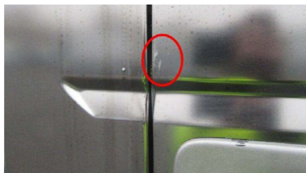
Пукнатина на работ на вратата
